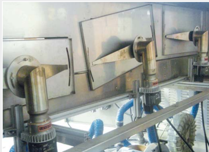
Individuelle Ausrichtung der Leister-Breitschlitzdüsen auf das Schrumpfgut.
