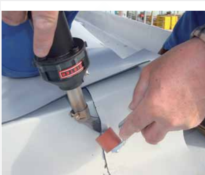
...y el pequeño HOT JET S durante la soldadura de los pequeños detalles.
