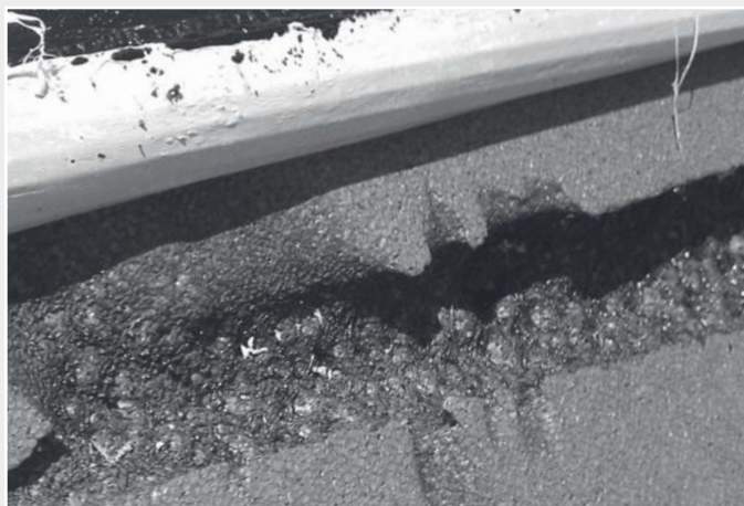
Endommagement de l'isolation thermique par une flamme nue. Ces dommages sont évités avec le BITUMAT B2.
