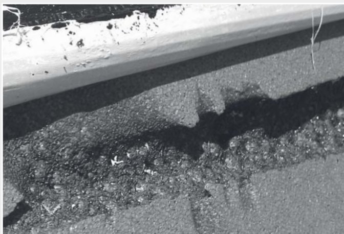
Beschädigung der Wärmedämmung mit offener Flamme. Mit dem BITUMAT B2 wird dies vermieden.
