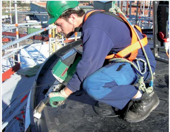
En la imagen anterior se está conectando en España la pared con los elementos del techo con la máquina WELDPLAST EC 4.
