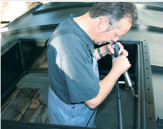
La ventanilla de inspección se fijó con la herramienta DIODE S de Leister.
