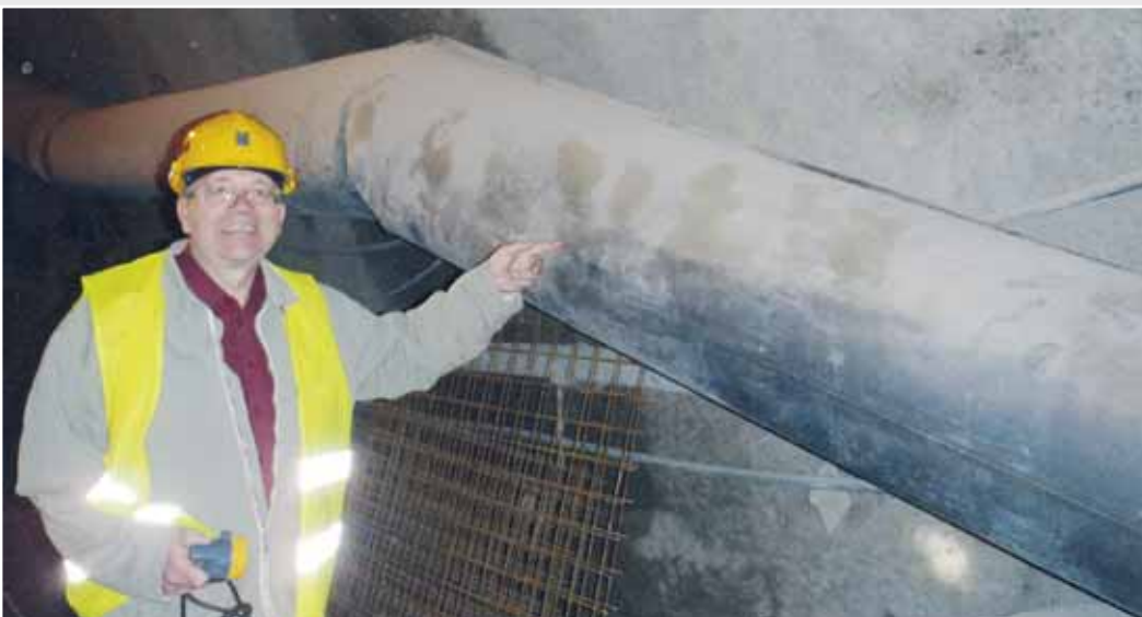
El propietario de la empresa Jirí Zajdlík con un canal de aire Duflex en una galería minera.
